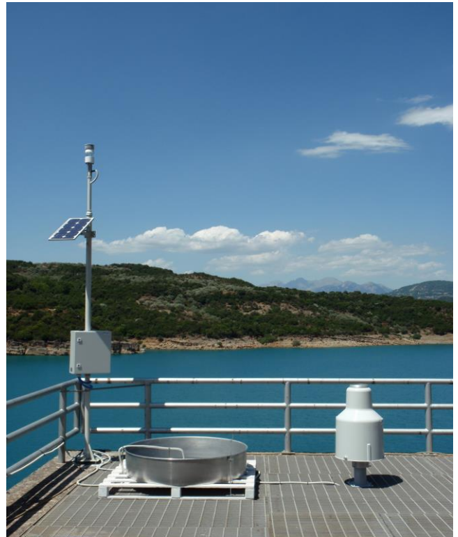
Σταθμός λίμνης Κρεμαστών
